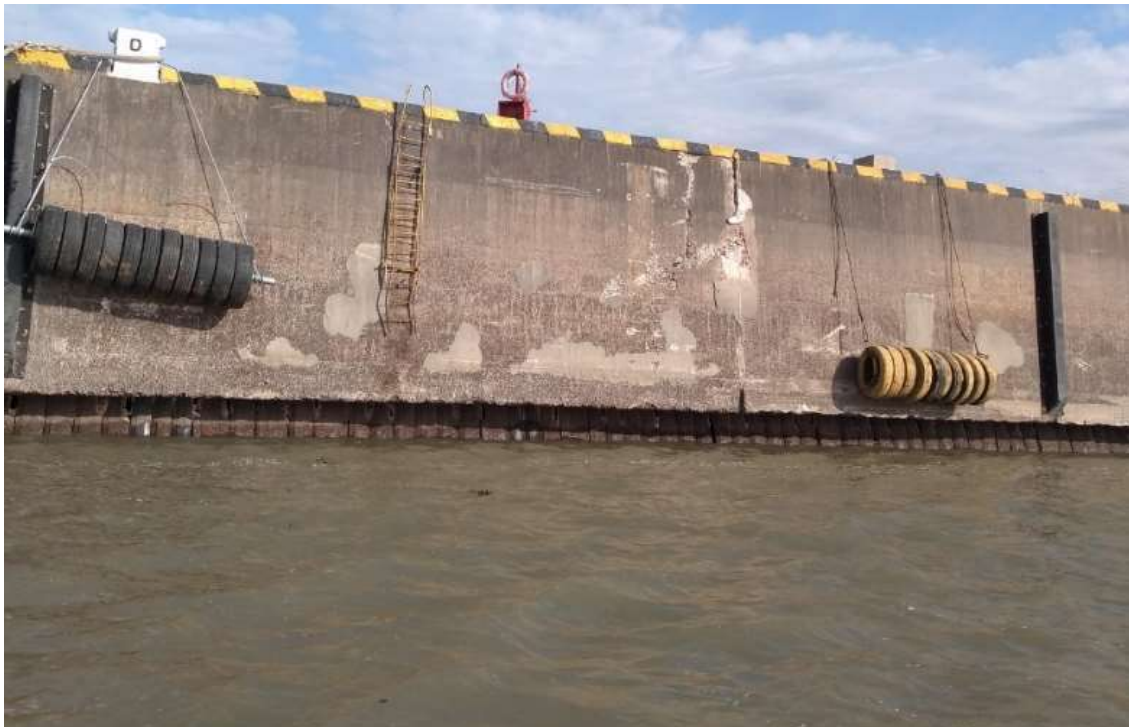
Figura 4 Fotografía del sector dañado del muelle cerca de la bita D.
