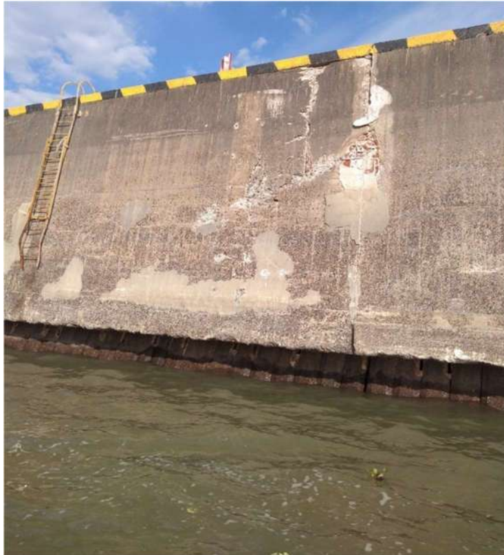
Figura 3 fotografía del sector dañado del muelle, sector bita D
