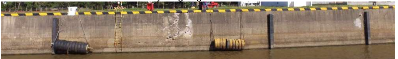
FOTO 1. Sector de colisión en el muro de atraque del muelle.
