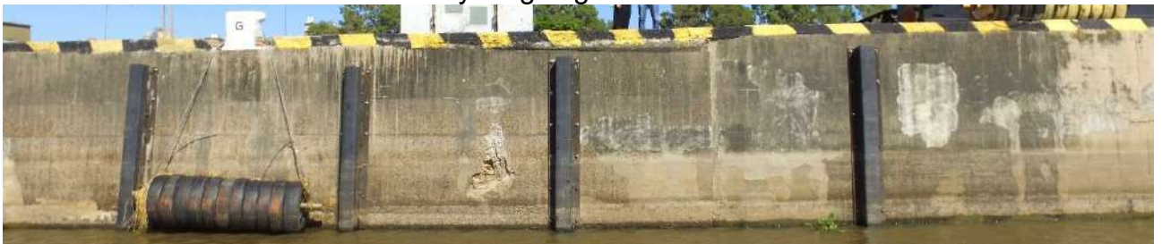
FOTO 2. Sector de colisión en el muro de atraque del muelle.
